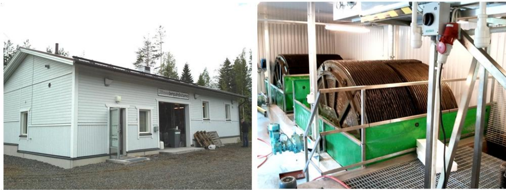
Kuva 6. Suomenniemen Kirkonkylän jätevedenpuhdistamo ja buiorottoriprosessi.
